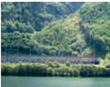
ENDE: Den nye kraftlinjen kan ende i koblingsanlegget i Vassbygdi i Aurland. FOTO: KNUST STRØM
